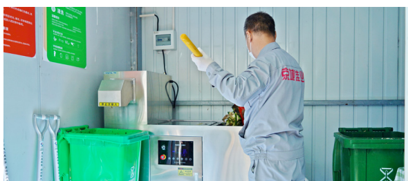
工作人員在操作廚餘垃圾資源處理器
